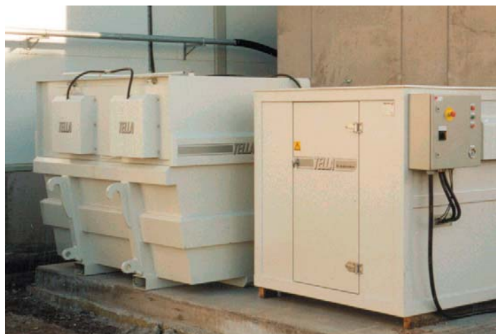
Ciepłownia. Elektryczny agregat próżniowy i mobilna stacja filtrów.
