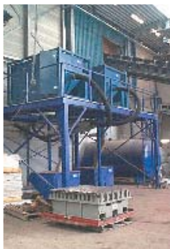
Wytwórnia betonu. Równoległa praca dwóch agregatów typu SEBF-II.
